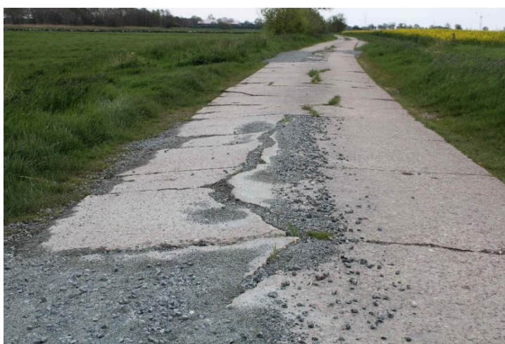
Foto 8: Stark zerbrochener und auch für Fahrradfahrer nicht mehr sicher befahrbarer Betonplattenweg nördlich von Sievern (Stadt Geestland, Landkreis Cuxhaven)
