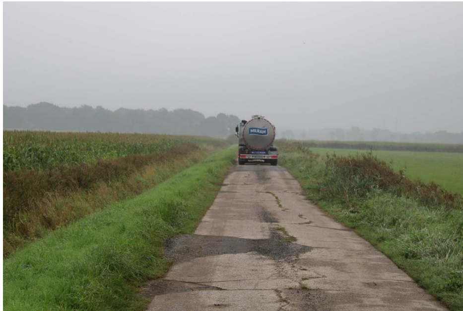
Foto 2: Nutzung eines stark geschädigten Betonplattenweges in der Gemeinde Wremen (Landkreis Cuxhaven) durch Milchtankwagen
