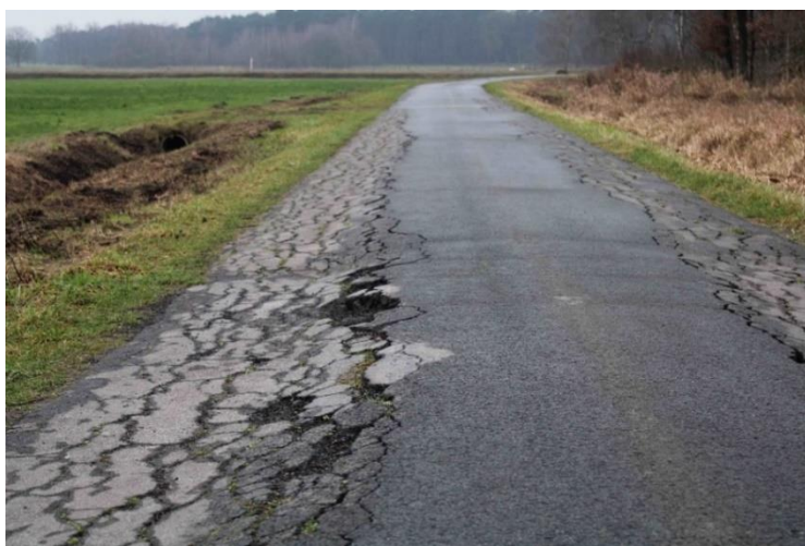
Foto 9: Extrem stark geschädigte Asphaltdecke aufgrund von Sackungen im Lichtenmoor (Landkreis Nienburg/Weser)
