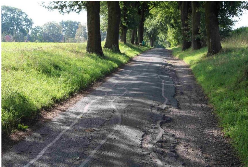
Foto 1: Sanierungsbedürftiger Weg im Ortsteil Laderholz der Stadt Neustadt am Rübenberge
