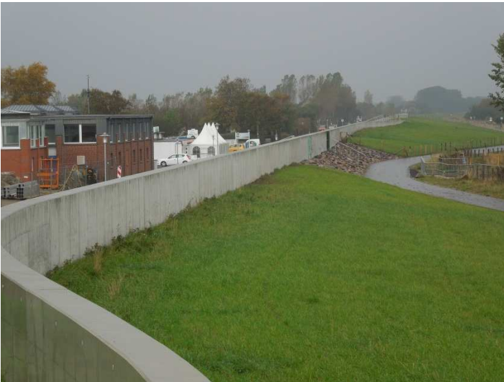
Abbildung 6: Hochwasserschutzwand auf der Deichkrone im Bereich des Schöpfwerkes Dahme mit seeseitigem Deichverteidigungsweg
